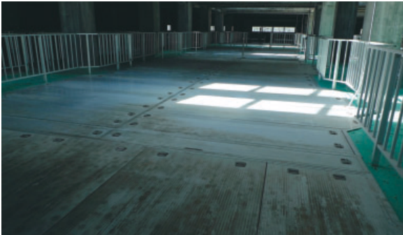
【写真 10】 最終沈澱池全景
