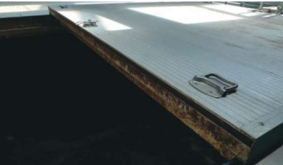
【写真 8】 エアレーションタンク（可動蓋側面）
