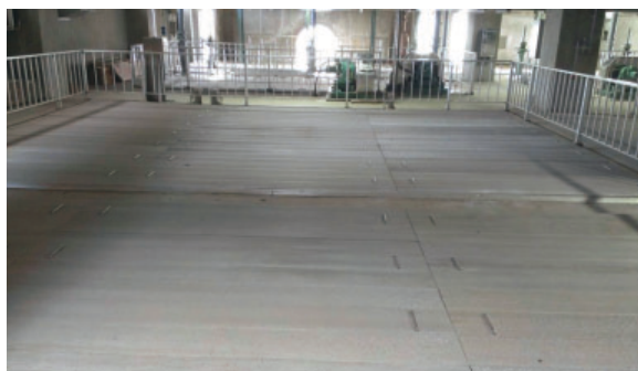
【写真1】 最初沈殿池
