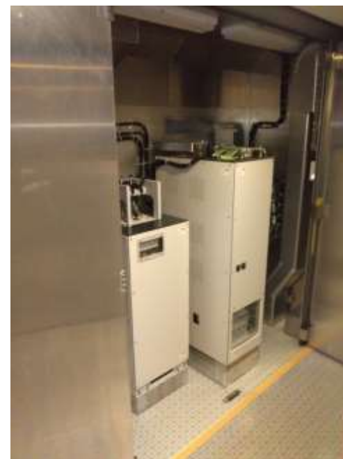
通信検測装置
