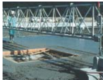
②7 ガーダー部にアルミニウムが使用されたコンクリート床ならし用ロボットは運搬、組立、解体作業の効率化に貢献
