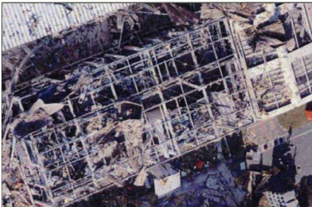
写真 2.1-1 粉塵爆発現場
